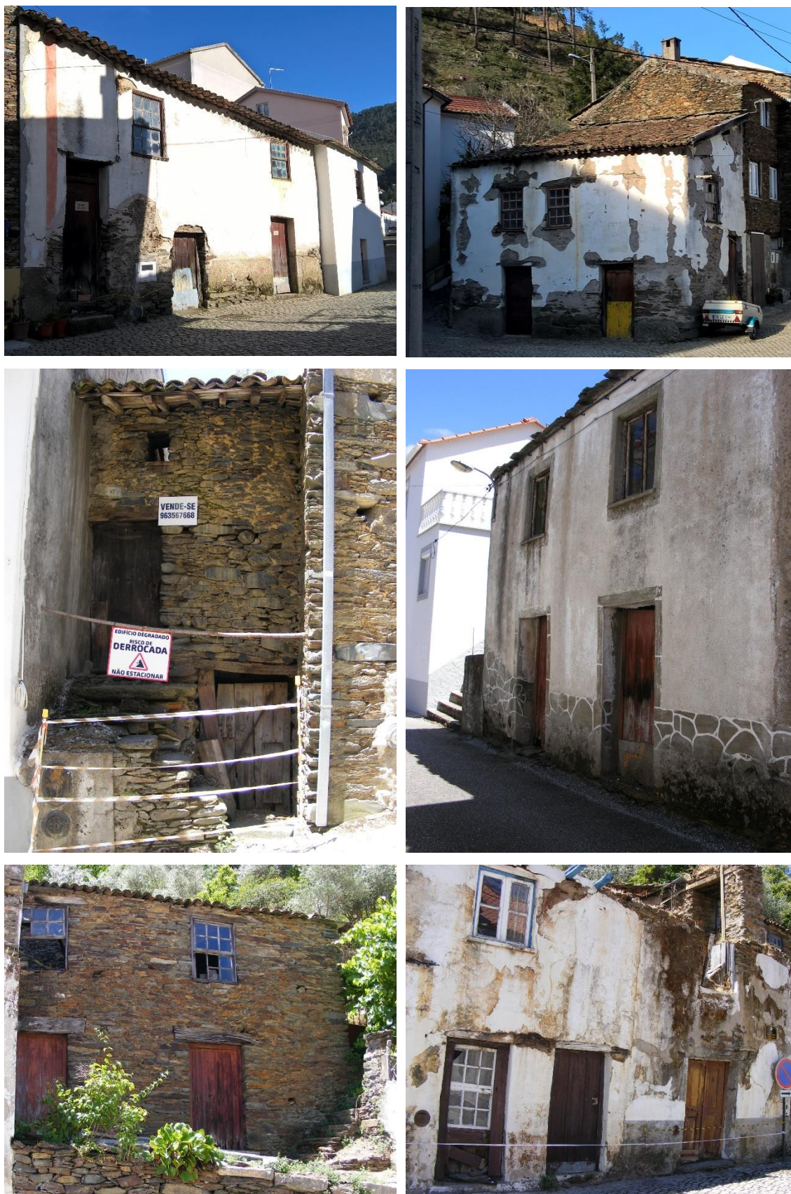
Figura 15: Edificado em ruína ou com grandes necessidade de reparação na ARU
